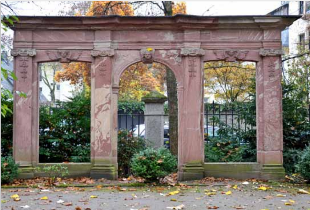
Noch steht der Torbogen im Garten
